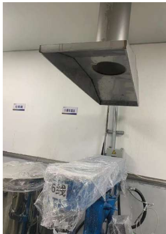
混料废气收集（集气罩）
