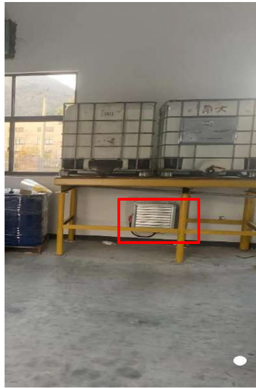
危废库废气收集
